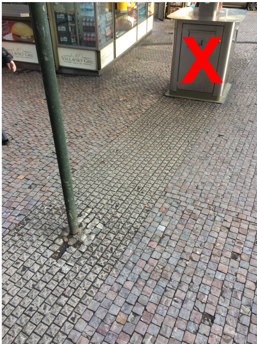
SP nesprávné řešení – více chyb, přímo v SP bariéry, chybí lemování SP atd.
