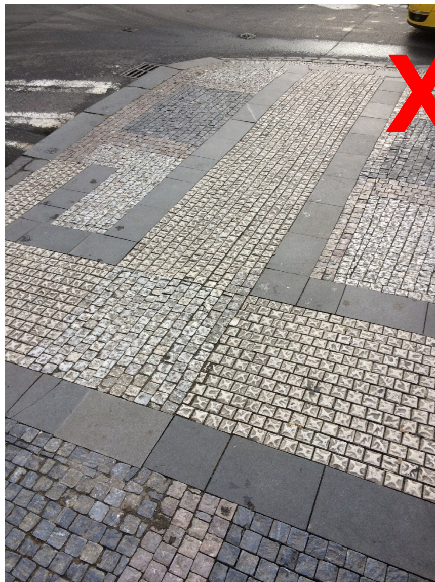
Nesprávné řešení křížení dvou SP, v místě křížení není hladká plocha
